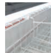
Iluminação interna em LED
